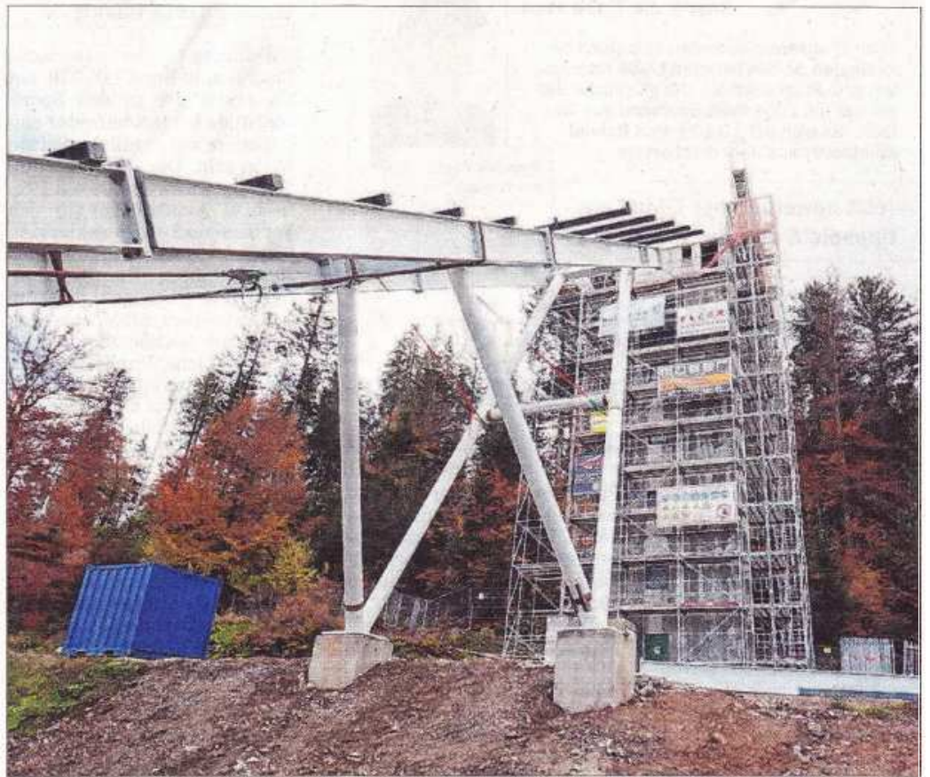
Der Schein trägt: Beim Umbau der Rothaus-Schanze in Hinterzarten passt der neue Stahlträger der Anlaufspur wegen eines Planungsfehlers nicht an den vorhandenen Anlaufurm. Foto: Joachim Hahne
